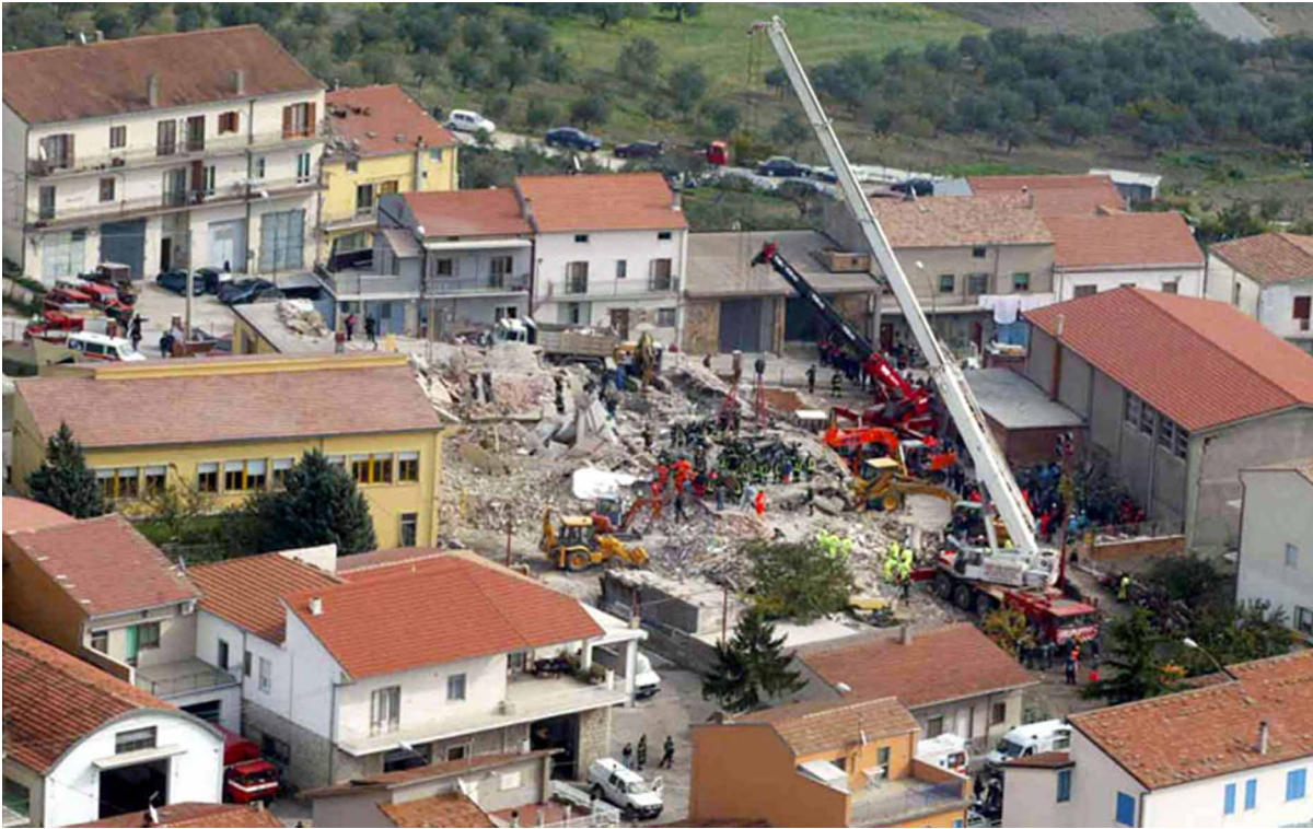
Figura 2 Il crollo della scuola di San Giuliano di Puglia, dopo il terremoto in Molise del 2002. Si nota chiaramente che l'edificio scolastico crollato è circondato da altri fabbricati praticamente intatti.
