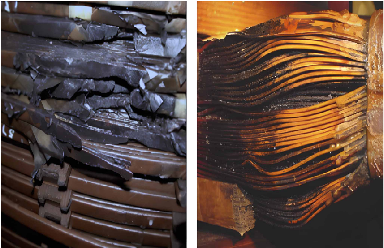
Figura 2 Trasformatori della rete di distribuzione elettrica del Sud Africa, danneggiati a seguito della tempesta magnetica dell'ottobre 2003. (Crediti: Eskom, Makhosi, T., G. Coetzee).
