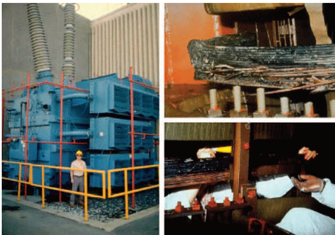
Figura 2 Danni ai trasformatori elettrici di un impianto di distribuzione in New Jersey dovuti all'accresciuta intensità di correnti indotte dalla tempesta. (Crediti: D. Di Mauro).
