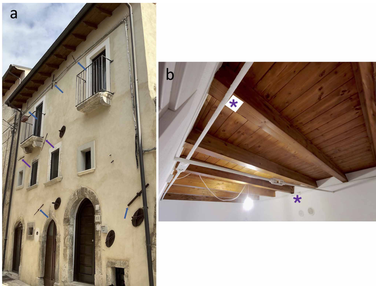
Figura 12 a) Prospetto di uno degli edifici di Rosciolo dei Marsi danneggiati dal terremoto del 1904, sul fianco destro della via rappresentata nella Figura 7c. Le frecce indicano i capochiavi a paletto dei tiranti apposti nell'edificio dopo il terremoto del 1904. I quattro capochiavi a piastra fanno riferimento a catene di più recente impianto. b) Ambiente dello stesso edificio in cui è visibile la disposizione dei tiranti con raccordo e sistema di tiraggio a vite; i ferri segnati con l'asterisco viola emergono in facciata in corrispondenza delle frecce con il medesimo colore.
