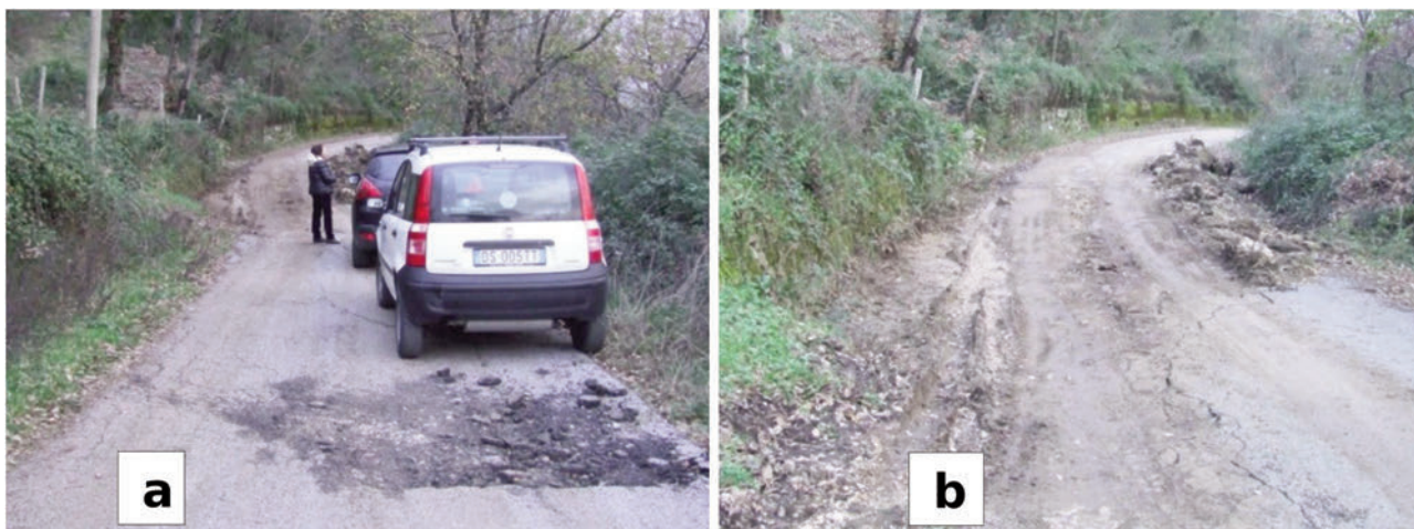
Figura 4 Frana con sprofondamento della strada. Si possono osservare le fratture nell'asfalto e il cedimento del bordo stradale (a, b). Figure 4 Landslide with collapse of the road. Fractures on the paved road and collapse of the road edge (a, b).
