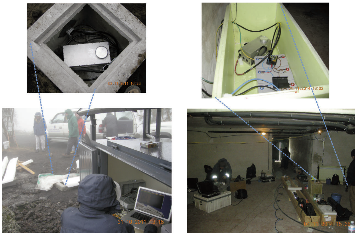
Figura 6 L'aspetto esterno dell'elettronica di controllo ( Shoebox ) e la sua tipologia di ubicazione nei siti remoti. A sinistra la soluzione (adottata a DRUV, DEGI e DMSC) di un apposito pozzetto realizzato sotto terra per garantire una buona coibentazione. A destra la soluzione del contenitore coibentato ubicato all'interno del garage dell'osservatorio limitrofo alla perforazione dell'installazione. La Shoebox è collegata sia con il sensore in foro che con il sistema di alimentazione energetica e trasmissione. Vedi dettagli descrittivi nel testo.
