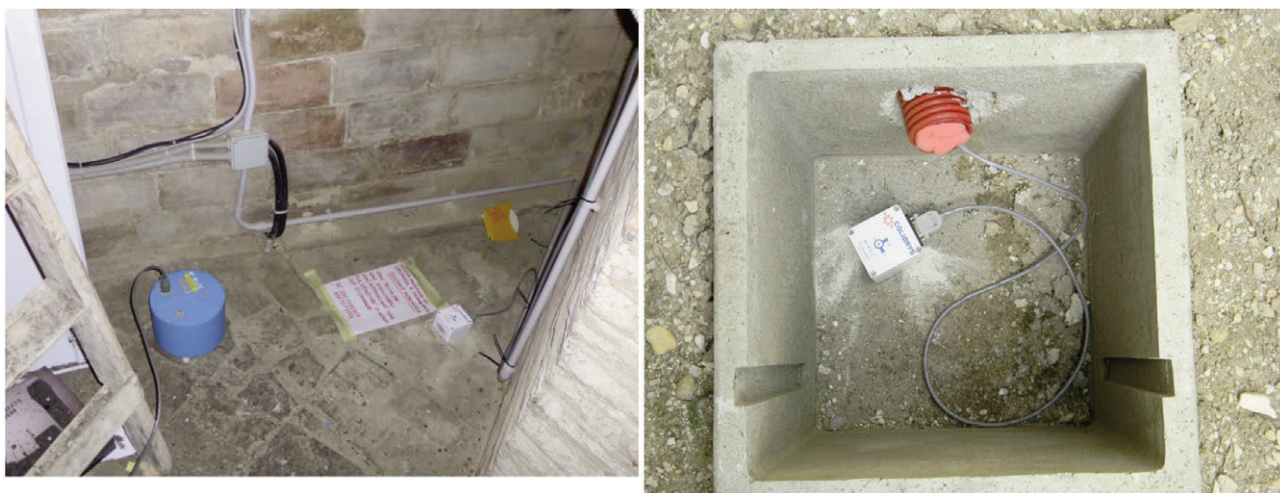
Figura 2 Esempi di installazione di accelerometri alla base degli edifici. Sinistra: accelerometro fissato alla pavimentazione al piano terra dell'edificio (stazione di TRE1). Destra: accelerometro installato in pozzetto (stazione SSM1).
