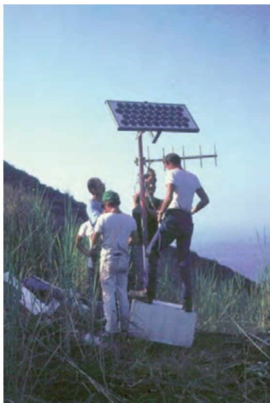
Figura 51 Installazione del sistema di trasmissione radio (foto G. Vilardo).
