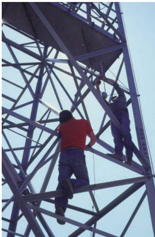
Figura 66 Installazione dell'antenna loop per la ricezione del segnale del tempo DCF77 sul traliccio della centrale SIP (foto G. Vilardo). Figure 66 Installation of the DCF77 loop antenna on the SIP pylon (photo G. Vilardo).
