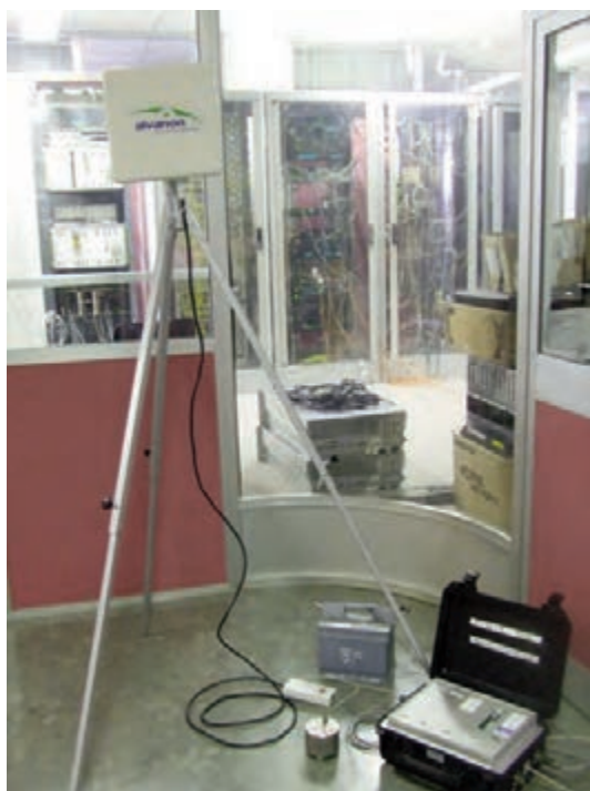
Figura 26 Stazione sismica Lennartz M24 collegata ad un sistema di trasmissione WiMAX Alvarion , realizzato da Alcatel , durante la sperimentazione del sistema WiMAX (foto M. Castellano). Figure 26 Lennartz M24 seismic station linked to a WiMAX Alvarion transmission system during the WiMAX test (photo M. Castellano).
