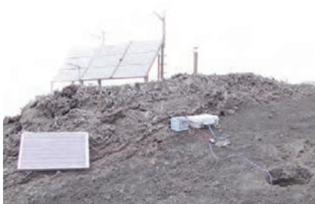
Figura 108 Installazione di una stazione sismica Lennartz MARSlite in località Cratere del Piano (foto M. Castellano). Figure 108 Lennartz MARSlite seismic station installation at Cratere del Piano site (photo M. Castellano).
