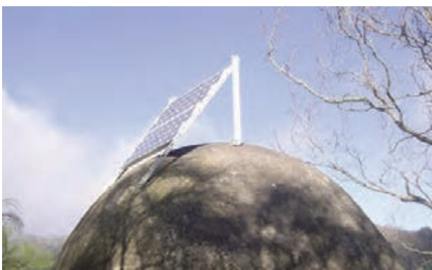
Figura 73 Sistema di pannelli solari installato su Bunker Nord, versante settentrionale del Gran Cono (foto M. Castellano).
