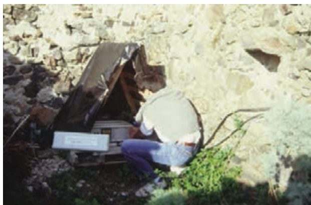
Figura 64 Controllo del funzionamento di una stazione Lennartz PCM 5800 installata a Lipari (foto G. Vilardo).
