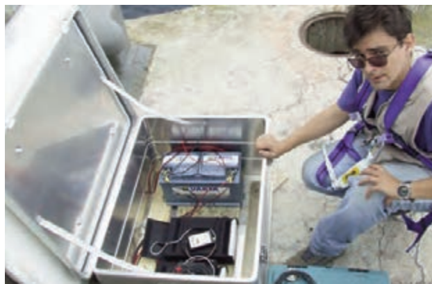
Figura 94 Acquisitori Lennartz MARSlite installati presso la stazione idrofonica PNI (foto M. Castellano).
