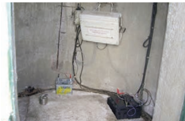
Figura 72 Stazione Lennartz PCM 5800 , equipaggiata con un sismometro Lennartz LE-3Dlite , installata presso il sito di Bunker Nord. La batteria Varta alimenta il solo sismometro (foto M. Castellano).
