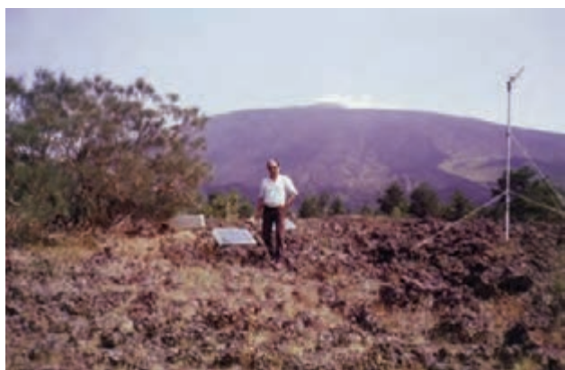
Figura 57 Installazione della stazione Lennartz PCM 5800 in trasmissione radio in località Monte Nespole, Adrano (foto J. Dorel).
