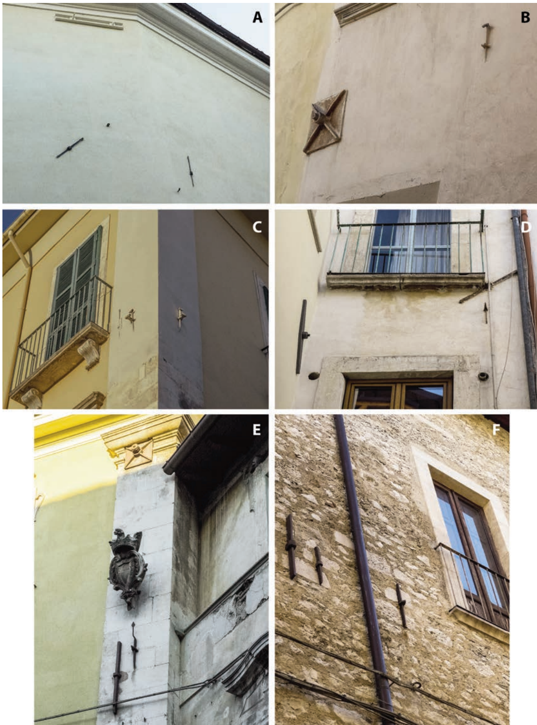
Figura 22 Interventi strutturali di epoche diverse negli edifici del centro storico (vedi figura 1 per l'ubicazione): A) emergenze di tiranti applicati nel corso del Novecento in largo Mazara; B) emergenza di tiranti, novecentesco (sinistra) e pre-novecentesco (destra) in via Corfinio; C) emergenze di un tirante novecentesco (sinistra) e di due tiranti pre-novecenteschi (destra) in via Manlio D'Eramo; D) emergenza di tiranti in edifici di via Papa Innocenzo VII: sulla destra, in alto, intervento strutturale novecentesco; in basso, intervento strutturale forse pre-novecentesco; sulla sinistra, si può notare l'emergenza di un tirante applicato dopo il terremoto del 2009; E) evidenze di interventi strutturali novecenteschi (in alto e in basso) e di un intervento pre-novecentesco in largo Palizze; F) interventi strutturali novecenteschi in vico dell'Ospedale, sul fianco settentrionale del complesso della S.S. Annunziata.
