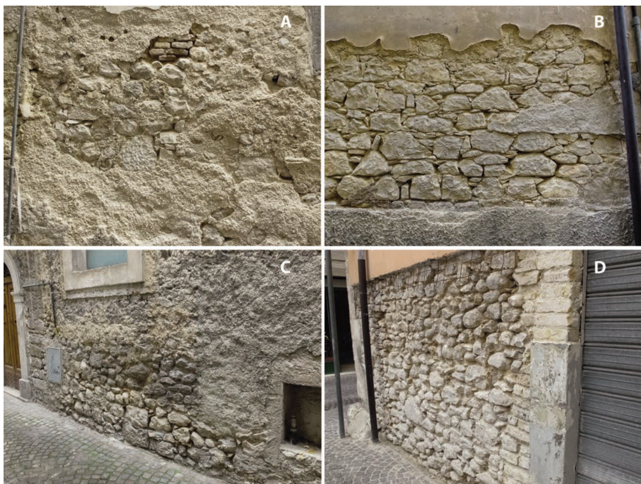
Figura 4 Caratteristiche murarie degli edifici del centro storico di Sulmona (si veda la figura 1 per l'ubicazione): a) via Peligna; b) vico Odorisio; c) via G. Quatrario; d) vico Merlino.
