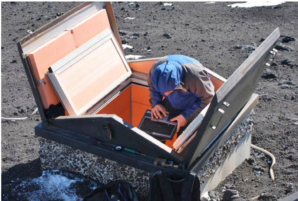
Figura 4. Configurazione e controllo software del digitalizzatore eseguita durante l'installazione in campo (EBEL).
