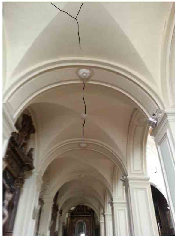
Figura 7c. Danni osservati dall'interno della chiesa Ave Gratia Plena. Danno stimato D2-Medio. Le lesioni sono state graficamente evidenziate. (Gentile concessione del parroco Don Alfonso, vicario del Vescovo – Foto Arch. A. Pascarella).
