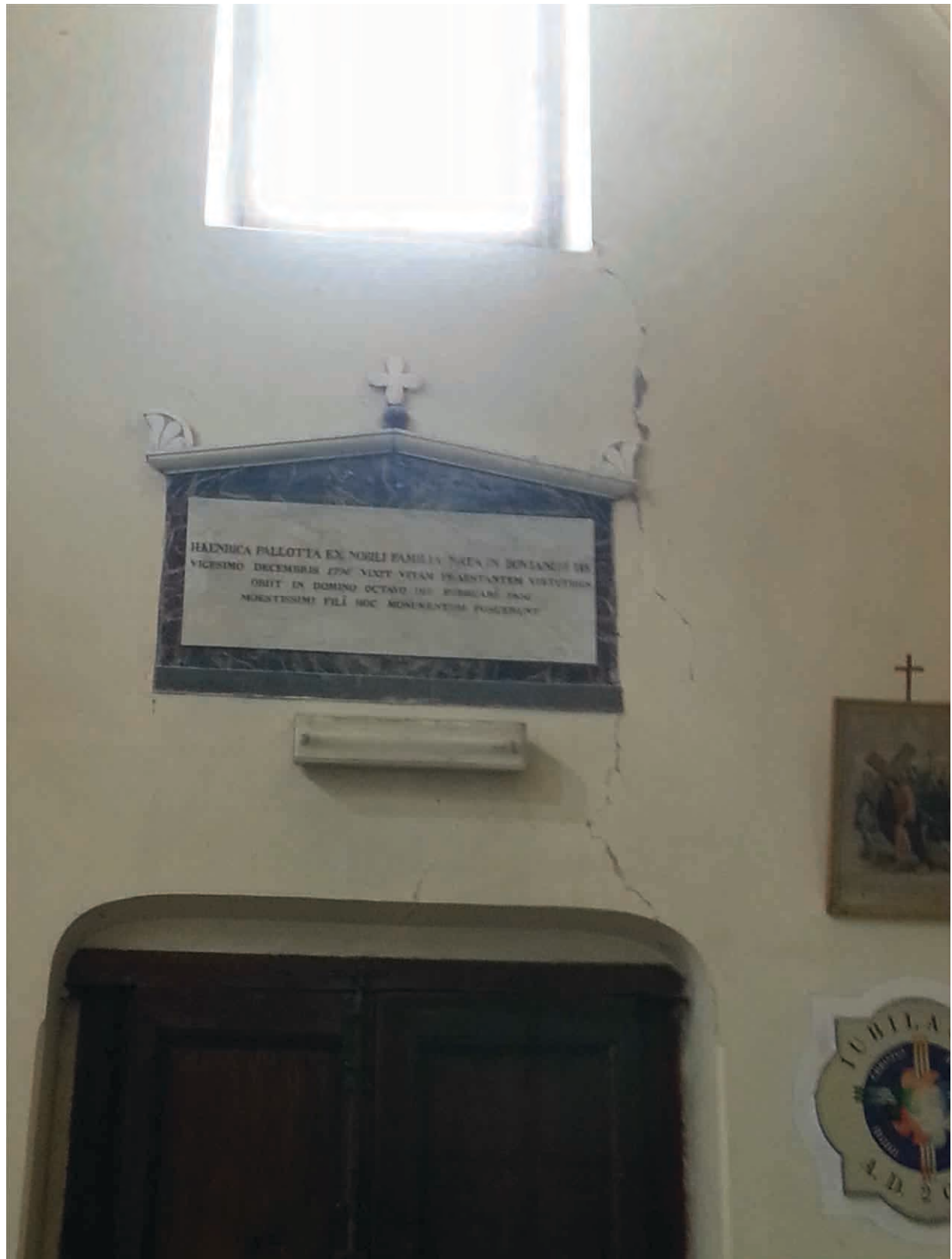
Figura 7d. Danni osservati dall'interno della chiesa Ave Gratia Plena. Danno stimato D2-Medio. (Gentile concessione del parroco Don Alfonso, vicario del Vescovo – Foto Arch. A. Pascarella).
