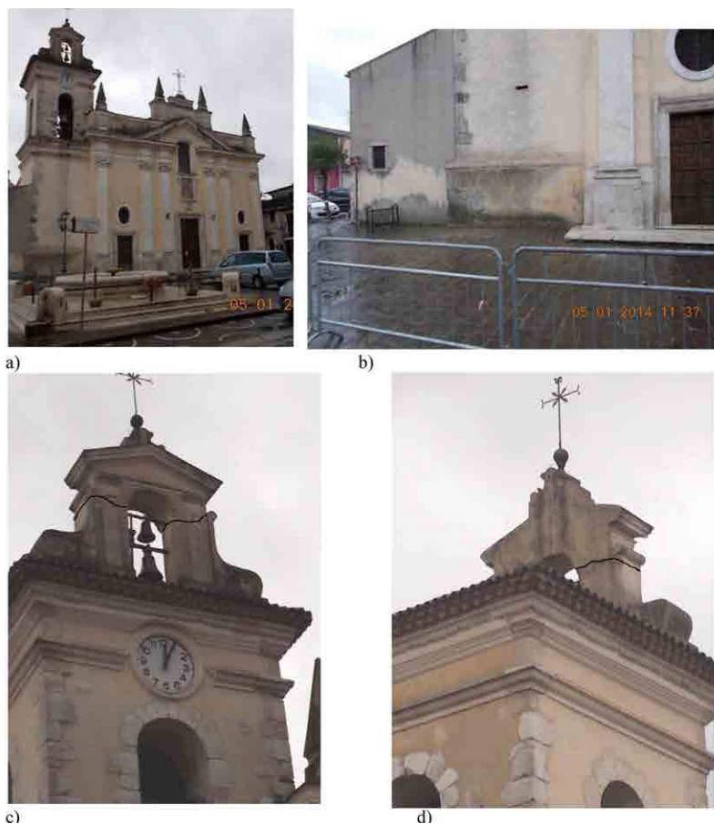
Figura 4. Danni alla torre campanaria della Cattedrale. Livello di danno stimato D3-Grave. Le lesioni nelle foto c) e d) sono state graficamente evidenziate.
