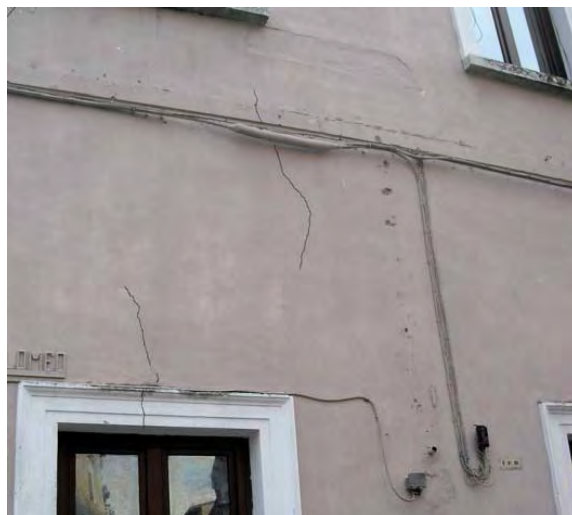
Figura 16. Lesioni alla facciata del Municipio. Livello di danno stimato D3-Grave.
