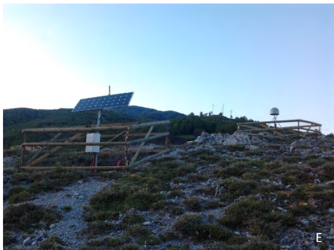
Figura 13. Le foto rappresentano le stazioni geodetiche di: A) Viggianello (PZ); B) Albidona (CS); C) Mormanno (CS); D) Colobrarò (CS); E) Acquaformosa (CS). Le schede tecniche di dettaglio dei siti installati sono riportate nell'allegato.
