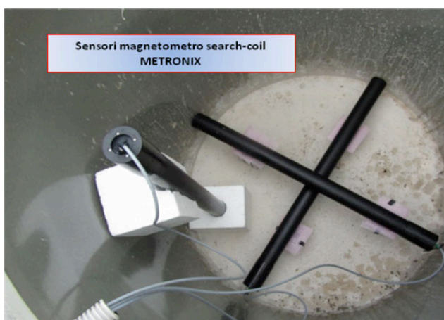
Figura 10. Cisterna contenente i tre sensori del magnetometro search-coil ADU-07 METRONIX, disposti ortogonalmente.
