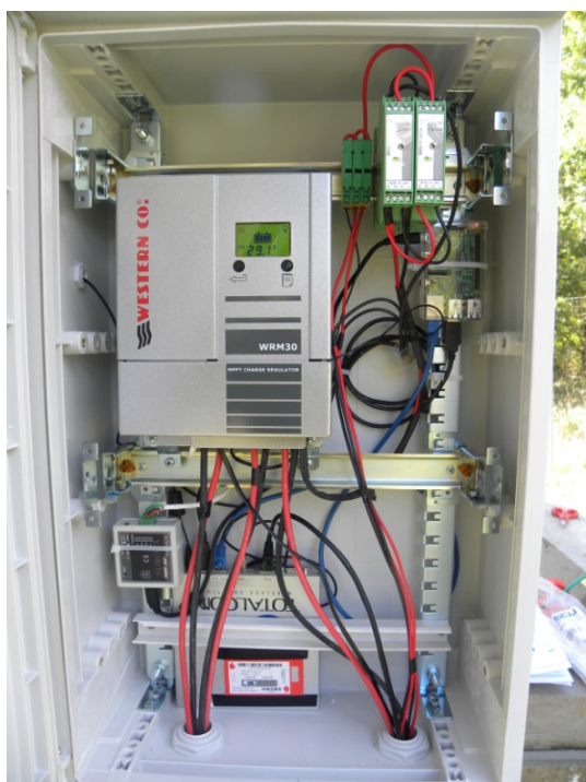
Figura 10. Quadro elettrico realizzato presso la stazione di Busso.
