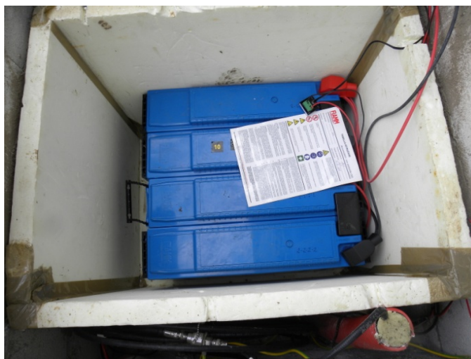
Figura 8. Accumulatori installati presso il sito di Busso.
