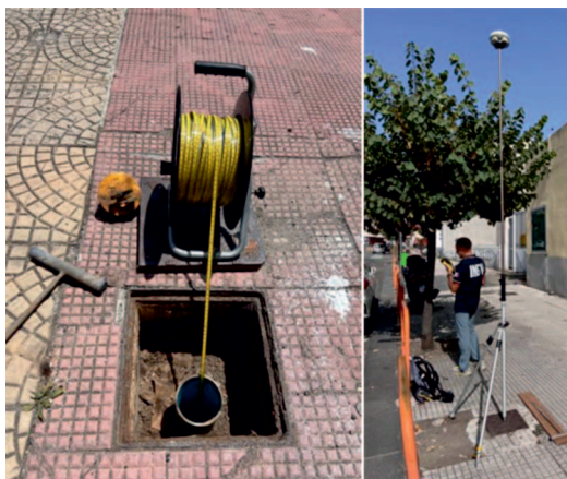
Figura 3 A sinistra, caratteristiche dei siti della rete piezometrica. In evidenza, l'estremo superiore del tubo in PVC da 4" che arma il foro piezometrico, contenuto in un pozzetto accessibile tramite chiusino metallico (visibile sotto il freatimetro). A destra, posizionamento del ricevitore GNSS per la determinazione della quota del chiusino.
