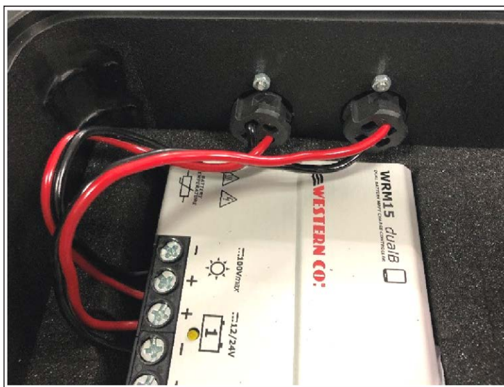
Figura 7 Collegamento dei connettori al regolatore di carica. A sinistra il pannello, a destra la batteria. Figure 7 Wiring of the connectors to charge regulator. Photovoltaic on the left, battery on the right.
