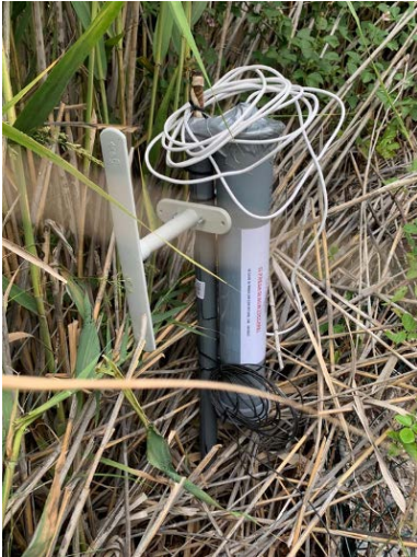
Figura 9 Installazione modem con antenna SIRIO 4G. L'immagine mostra un esempio di isolamento ideale per installare il modem in esterna e prevenire malfunzionamenti.
