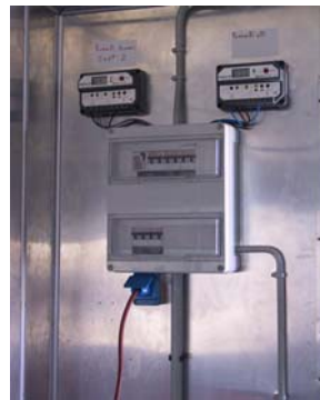
Controllori pannelli solari (LAB 1)
