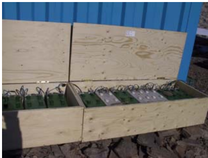
Accumulatori per i pannelli solari (LAB 1)
